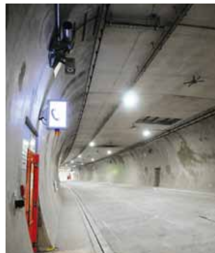
Bild 2 Der Pörzberg-Tunnel wurde als erster Tunnel Deutschlands mit einer stationären Löschanlage ausgerüstet.
